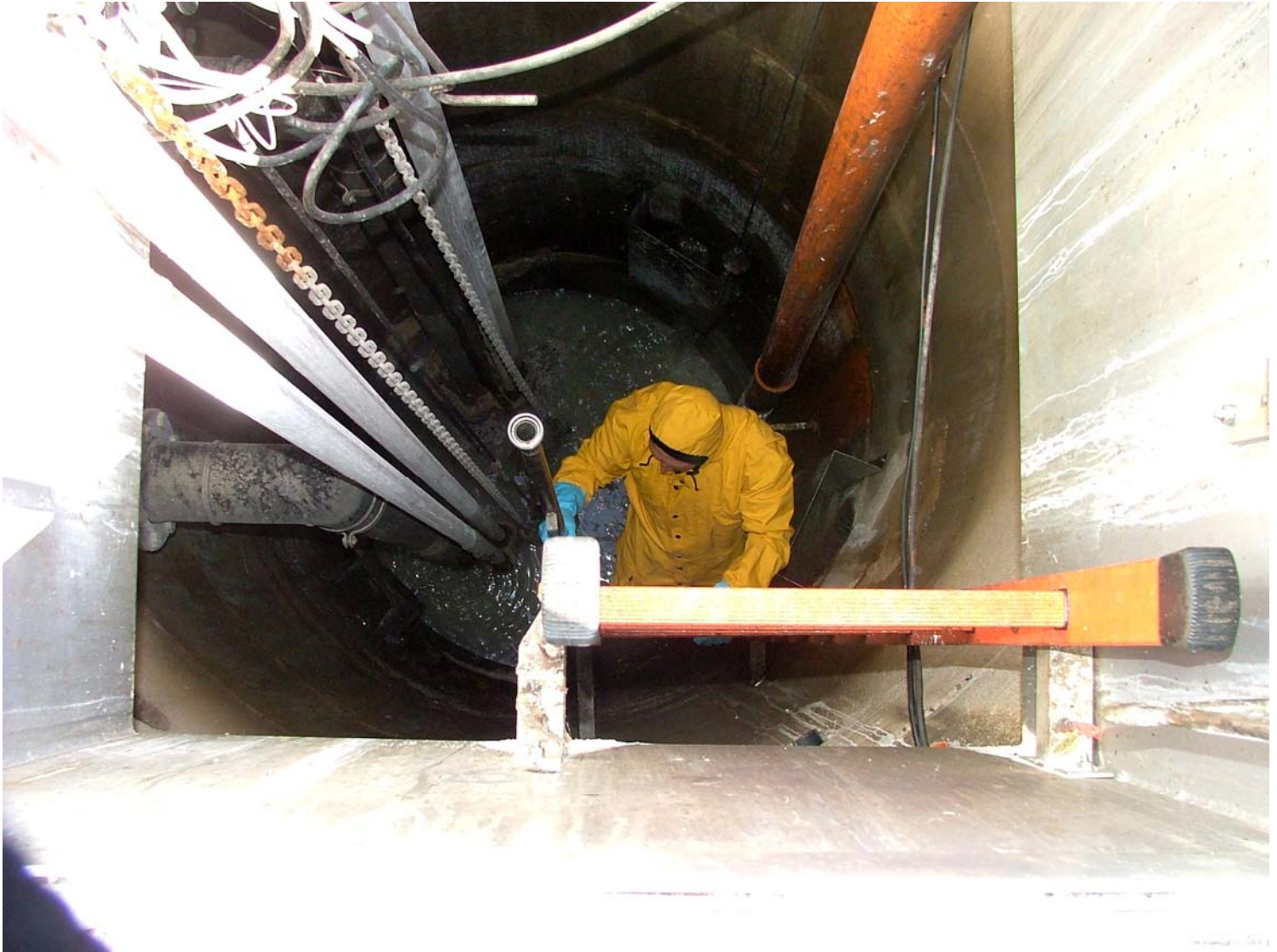
Bilden är från provtagningen i Oxledsvägens pumpstation.
